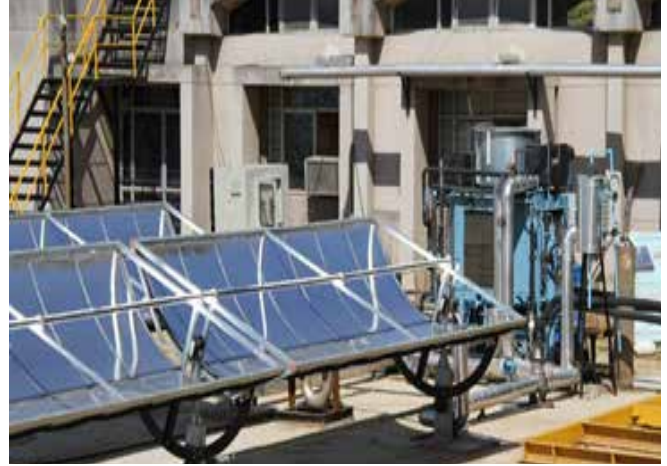
15 किलोवॉट सौर अवशोषण रेफ्रिजरेशन प्रणाली (एयर कूल्ड)
