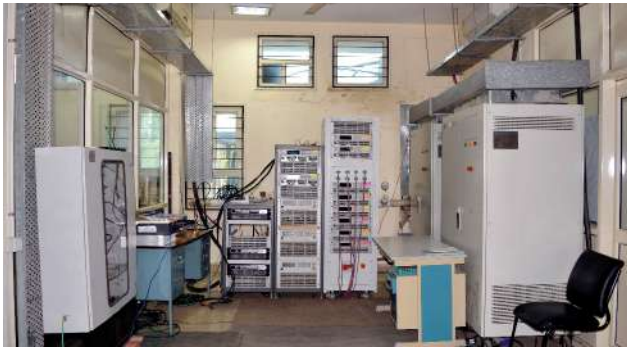
चित्र 3.13: पावर इलेक्ट्रॉनिक्स प्रयोगशाला सेटअप
